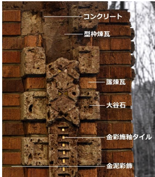
旧・帝国ホテル ライト館 大食堂の柱 施工＝大倉組土木部 | 博物館明治村蔵 | 筆者撮影 撮影協力＝博物館明治村
