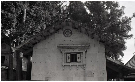
写真1 貼り石工法による石屋根の石蔵。漆喰の目地が剥がれ釘の頭が見える。明治初期建築（推定）宇都宮市西根。
